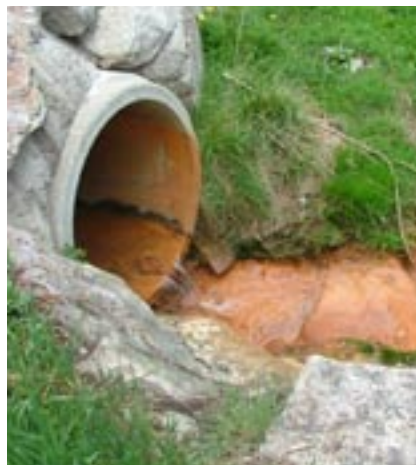
Eaux d'exhaures des mines
